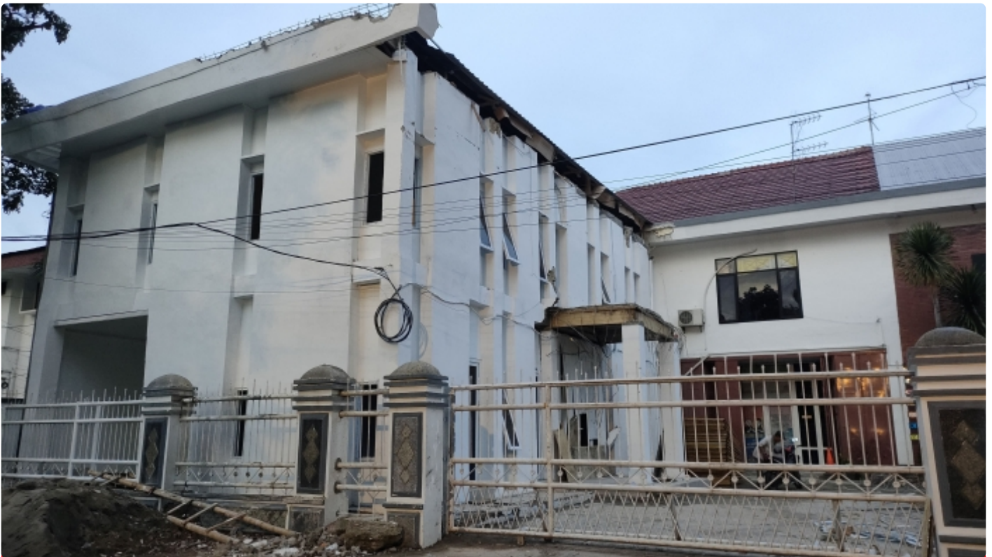
Puing - puing bangunan yang roboh di Kejari Medan, Jalan Adi Negoro terlihat sudah dibersihkan, Senin (14/11).
